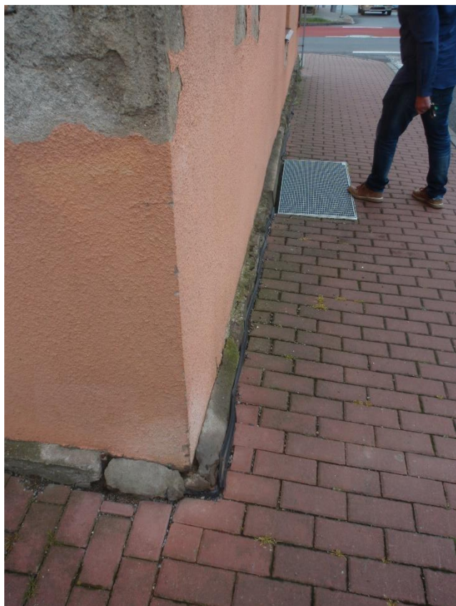
Patrné poruchy vlhkosti na zdivu z exteriéru, anglický dvorek v úrovni chodníku – možný problém se zatékáním dešťových vod do sklepa
