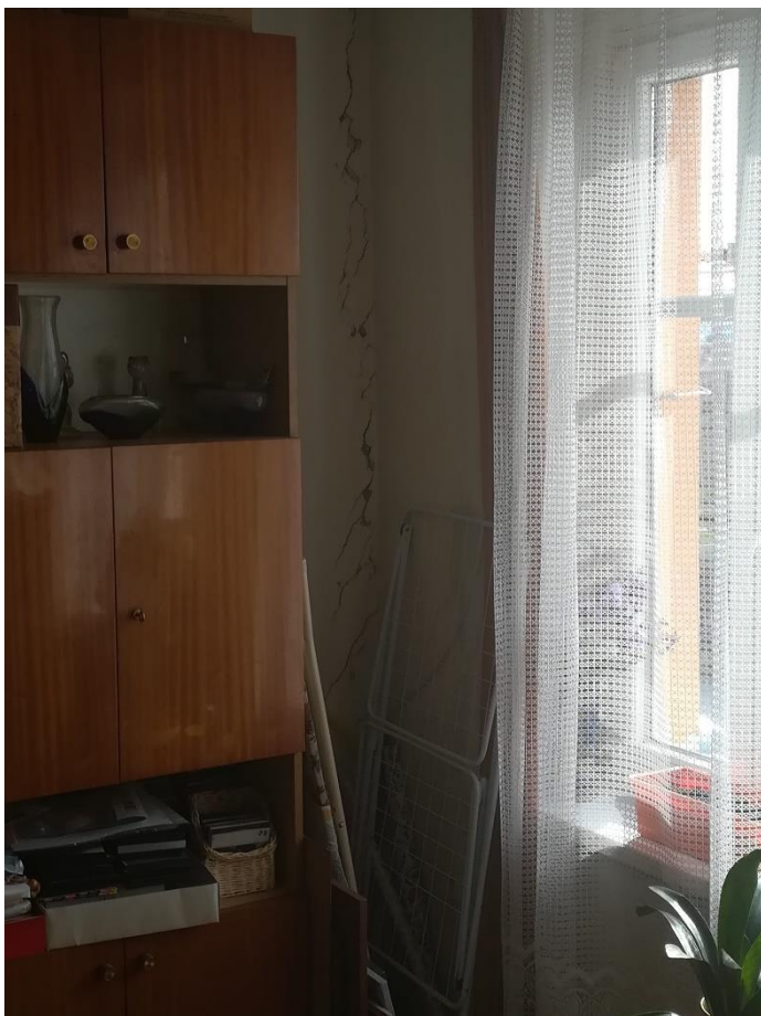
Statické trhliny ve vnitřním koutě v místě kde, navazuje vnitřní nosná zeď na obvodovou
