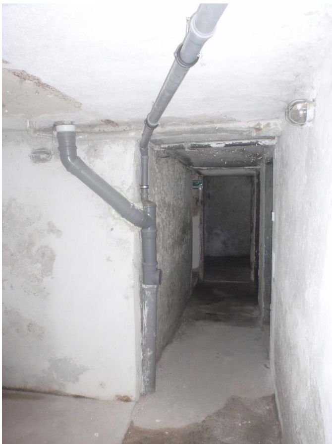
Sklepní prostor jeví známky poškození vlhkostí, lokálně vyměněné viditelné rozvody
